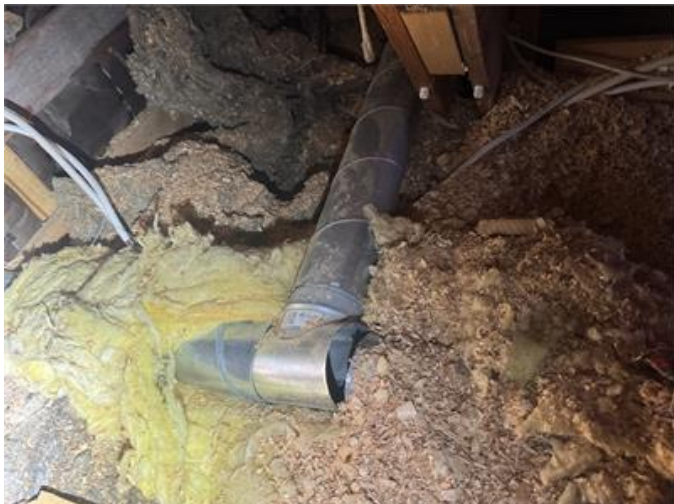
Ventilationsrör på vind som gått isär.
