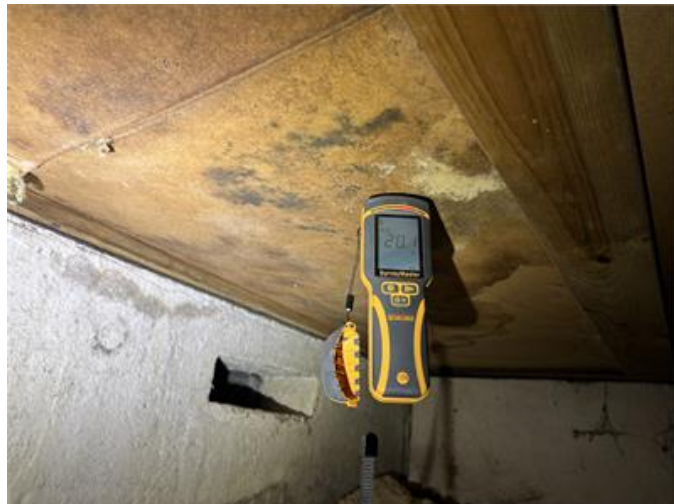
Bild visar missfärgningar under kök i kryppgrunden.
