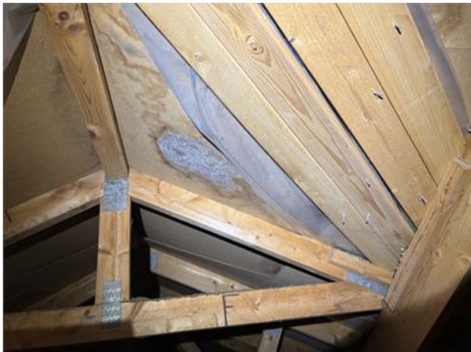
Bild visar missfärgningar på underlagstaket vid rännalen.
